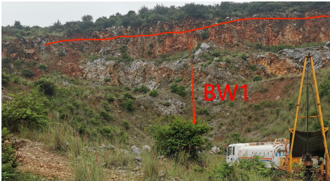
照片 4.1-3 BW 1 不稳定斜坡照片
