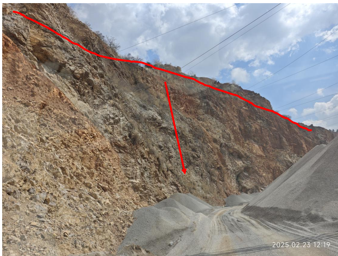
照片 4.1-1 BW 3 不稳定斜坡照片
